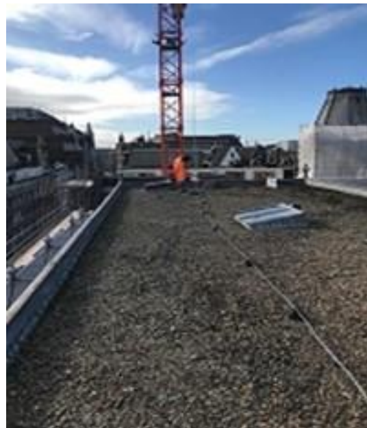
Foto: Grind op het dak
